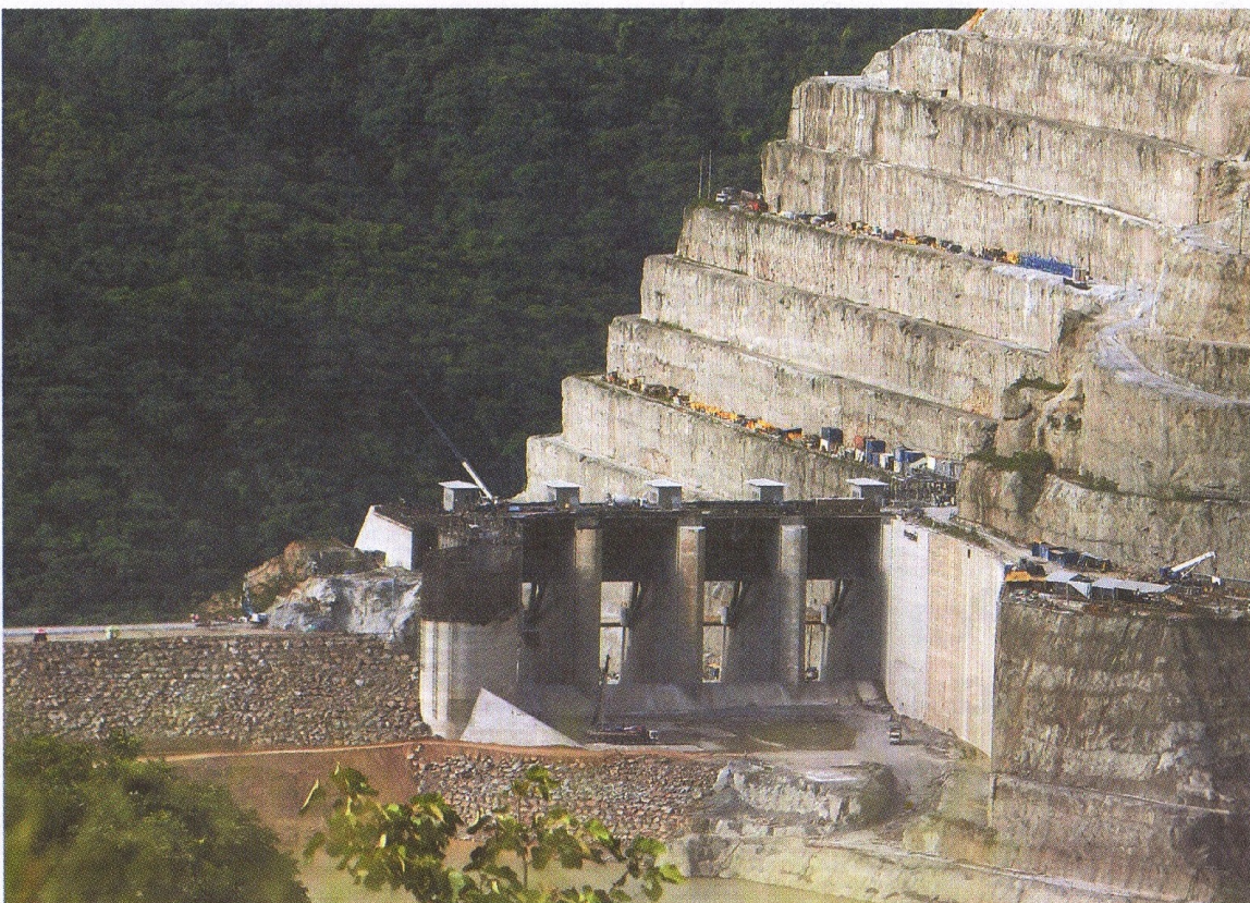
Durante la emergencia tuvieron que ser evacuadas cerca de 17.000 personas de cuatro municipios antioqueños que quedaron bajo riesgo ante una posible falla de la represa de Hidroituango. / EFE
