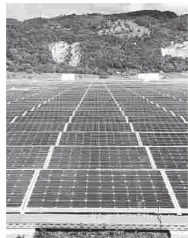
Las plantas contarán con una capacidad instalada de 400 MW. EFE
