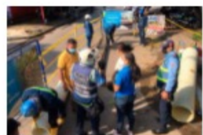
Colapsó alcantarillado en el barrio 9 de Abril, en Barrancabermeja
