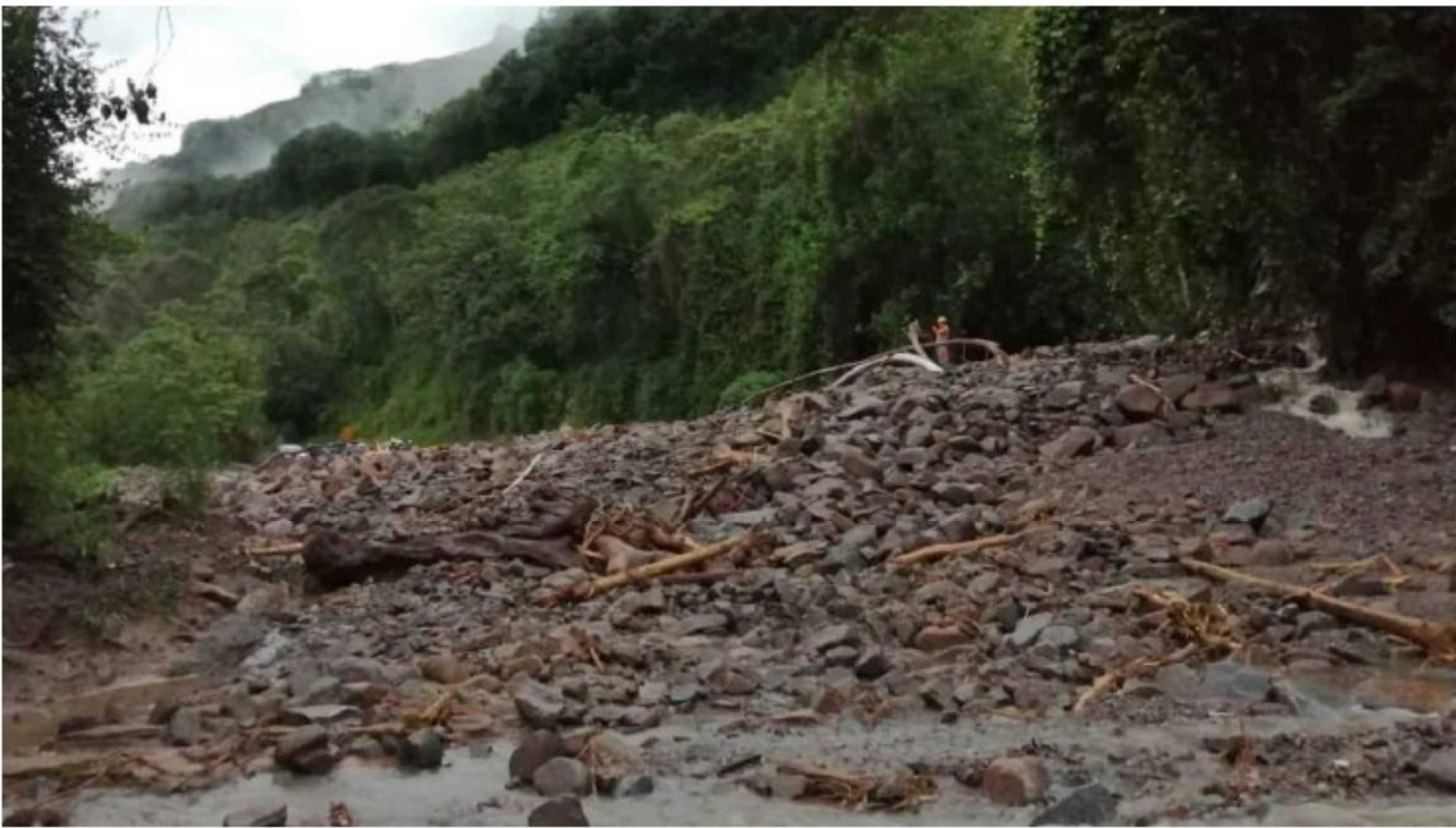
Luego de 17 horas se logró habilitar uno de los carriles a la altura del kilómetro 77+200, tramo donde se registró el movimiento en masa. - Foto: Foto:Twitter @PacíficoTres
