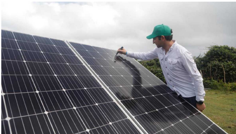
La granja contará con una capacidad instalada de 1,8 MWp y un sistema de almacenamiento con baterías. - Foto: MinEnergía - Edward Barragán
