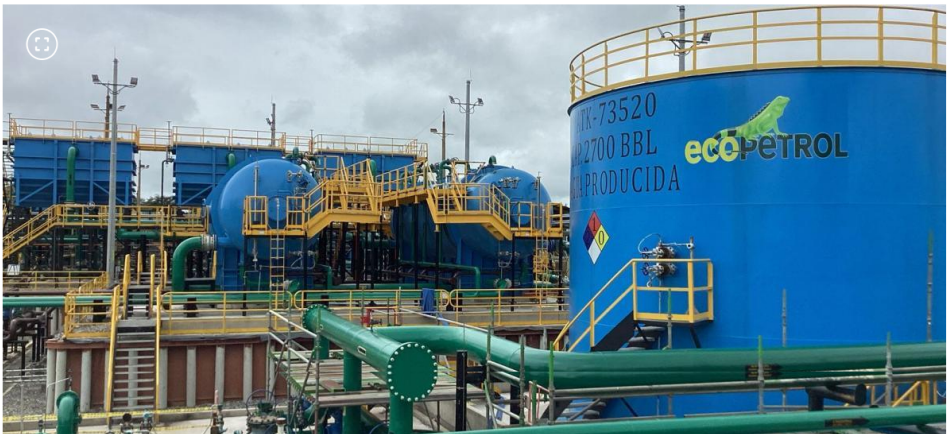
Sistema de Tratamiento de Agua de Producción (Stap) en campo Castilla. Foto: Ecopetrol
