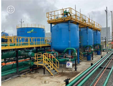
Sistema de Tratamiento de Agua de Producción (Stap) en campo Castilla. FOTO:ECOPETROL
