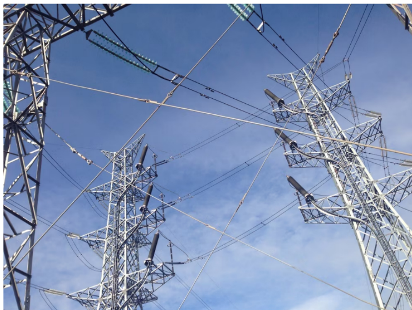
Torres de energía
