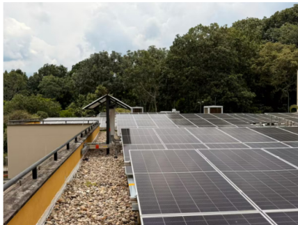
Estos son los paneles solares instalados en los techos del Icpet (Suministrada / VANGUARDIA).
