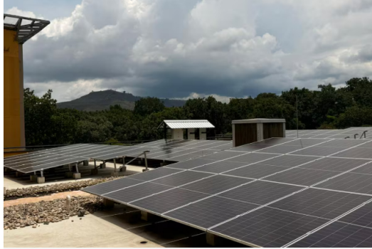
Estos son los paneles solares instalados en los techos del Icpet (Suministrada / VANGUARDIA).
