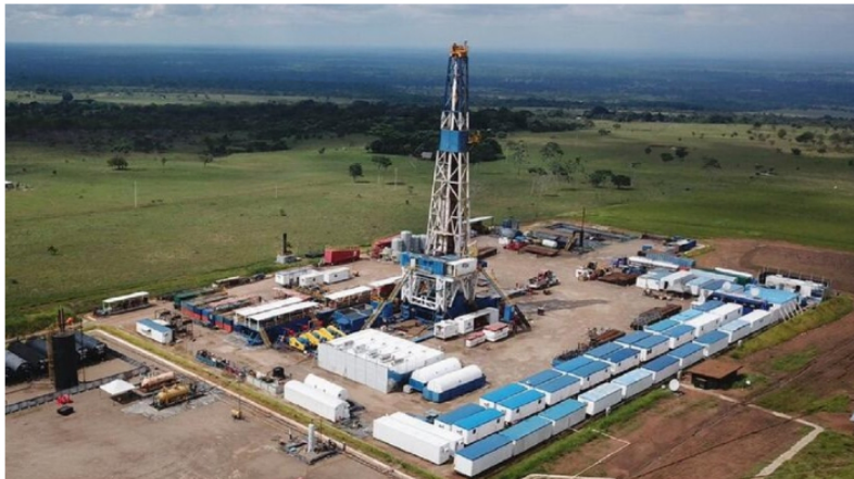
Campo Tibú, Ecopetrol Cortesía Ecopetrol
