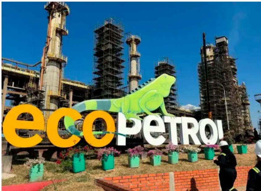
Ecopetrol avanza en la compra de los proyectos JK1 y JK2, que aportarán energía renovable para las operaciones del grupo empresarial. FOTO cortesía
