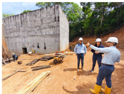
Los trabajos en la Planta de Lodos se reactivaron luego de que Ecopetrol, la Alcaldía y Aguas de Barrancabermeja lograran asegurar recursos adicionales por $11 millones. Suministrada/Vanguardia
